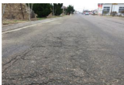
于家乔至北上乔：维修前
